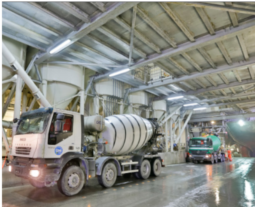
● Über einen fast 6km langen Stollen kann die Baustelle im Berginneren erreicht werden.
