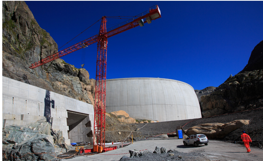
● Die Staumauer des oberen Sees Vieux Emosson auf 2225 müM, ursprünglich 1955 errichtet, wurde um 20 Meter erhöht. Dadurch wird die Kapazität des Staubeckens verdoppelt.
