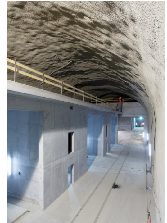
● Die Maschinenkaverne ist fertig ausgebaut und wird jetzt von der ABAG ausgerüstet.
