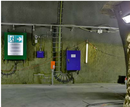
● So sieht der Passagier die Fluchtwegsignalisation.
