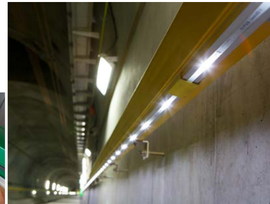
● Die beleuchteten Handläufe weisen den Weg.
