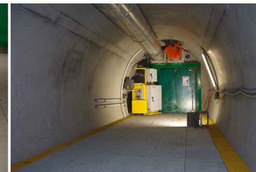
● Mit Doppelboden ausgerüsteter Querschlag.
