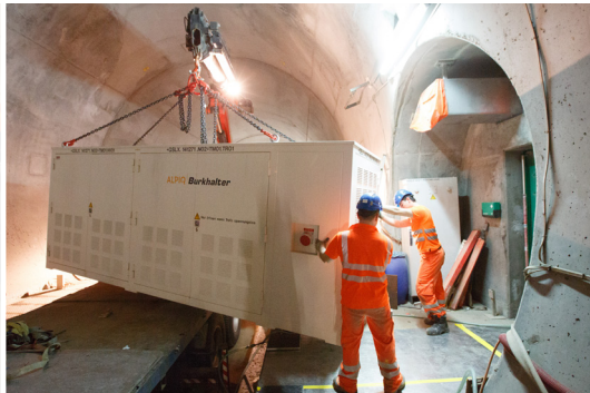
● Ein Elektroschrank für einen Querschlag.
