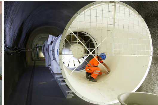
● Ventilatoren lüften den Tunnel.
