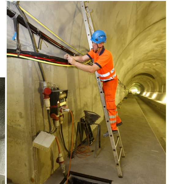
● Provisorisch angebrachte Stromleitungen.
