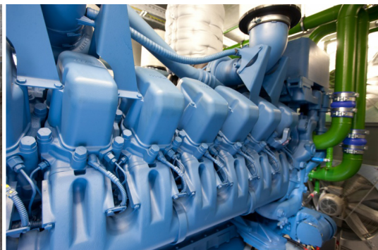
● Generator in einem Spezialcontainer in Bodio.
