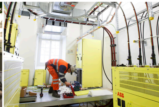
● Trafos werden mit Elektroschränken verkabelt.
